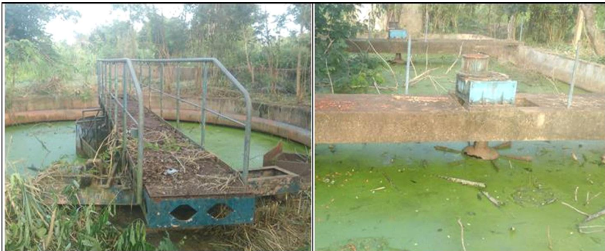
Рисунок 1.4- Станция очистки сточных вод [43]
