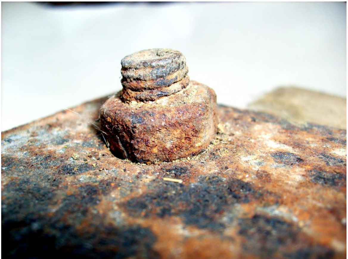
Рисунок 1.12 – Коррозионное поражение резьбового соединения
