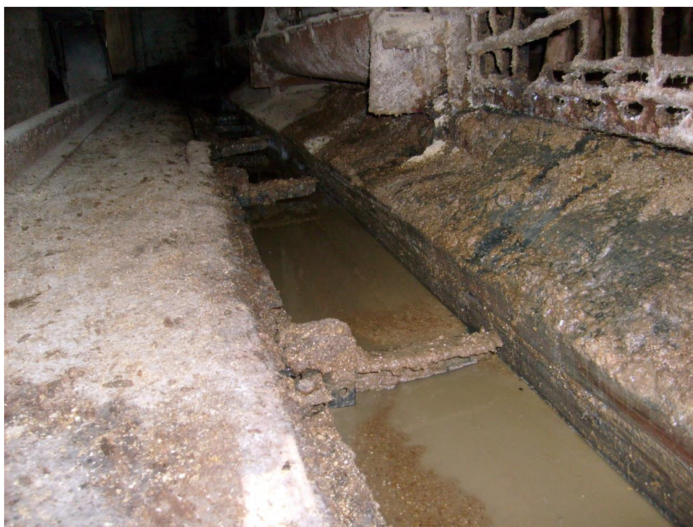
Рисунок 1.8 – Характер коррозионного износа деталей скребкового навозоуборочного транспортера в свиарнике
