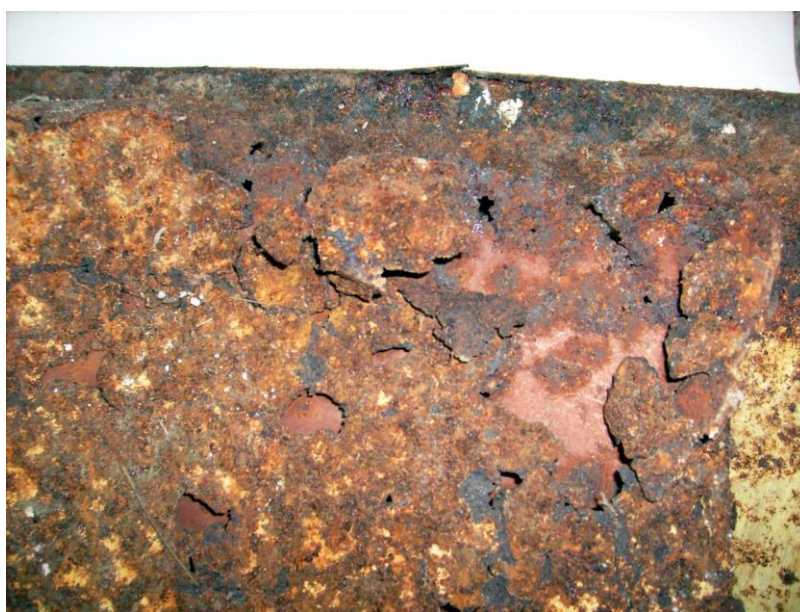
Рисунок 1.16 – Разрушение ЛКП и коррозия на поверхности вентиляционной шахты
