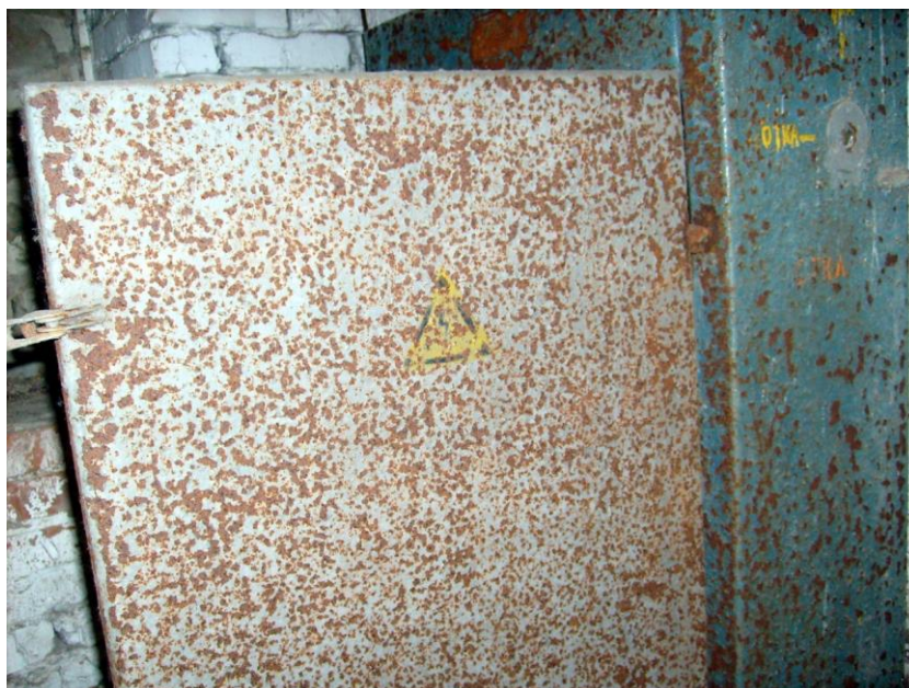
Рисунок 1.17 – Разрушение ЛКП и коррозия на дверце электрораспределительного щита
