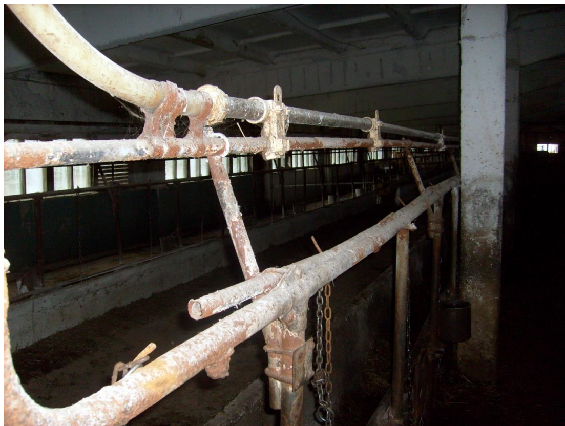
Рисунок 1.14 – Коррозия труб, применяемых для закрепления привязей животных в коровнике дойного стада
