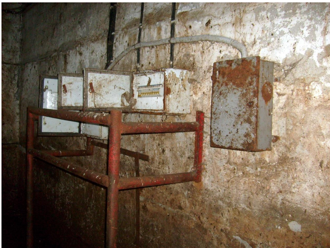
Рисунок 1.9 – Общий вид коррозионного поражения поверхностей контрольно-пускового электрооборудования коровника
