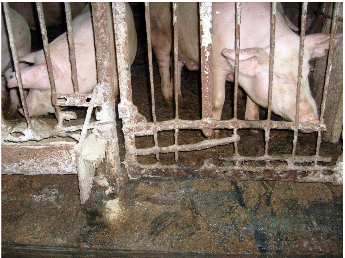
Рисунок 1.11 – Коррозия деталей ограждений свиарника
