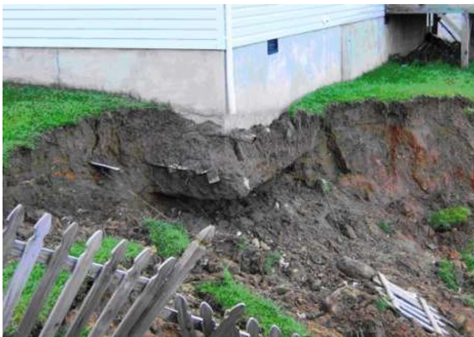
Рисунок 1 – Просадка сложного грунта на участке
