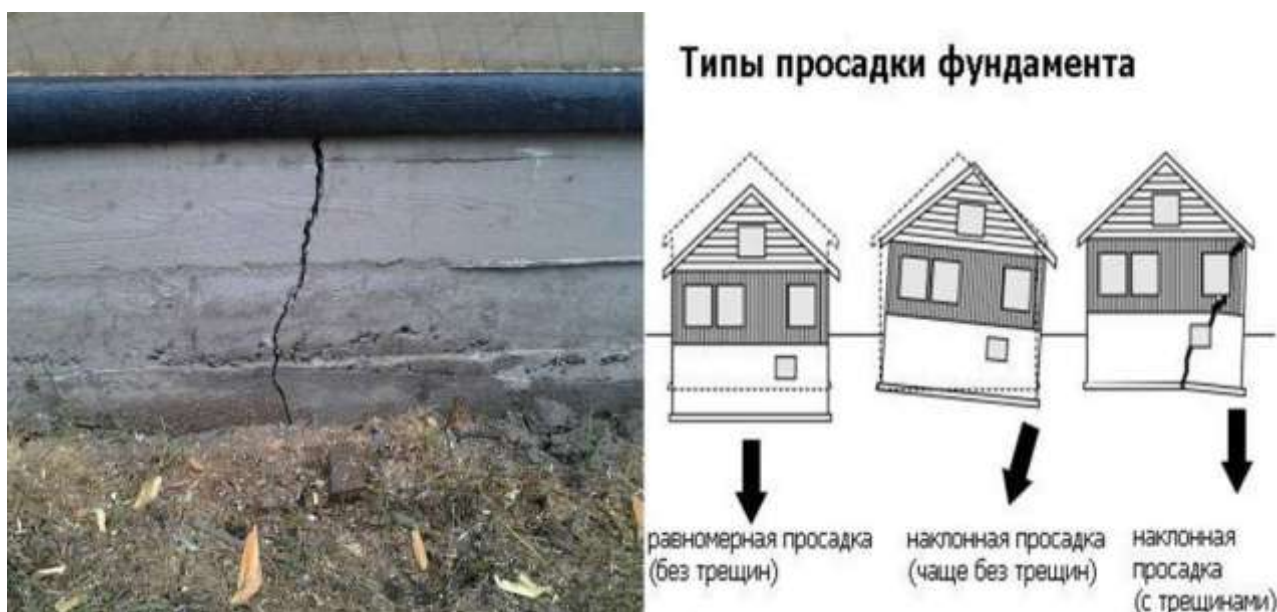
Рисунок 1 – Типы осадки фундамента и пример трещины
