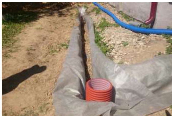
Рисунок 3 – Кольцевой дренаж, установленный по периметру частного дома
