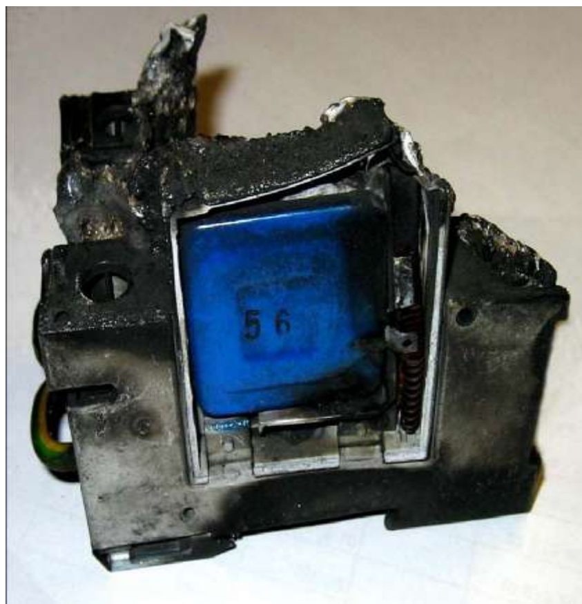
Рисунок 3 – Разрушение варисторного УЗИП при воздействии перенапряжения
