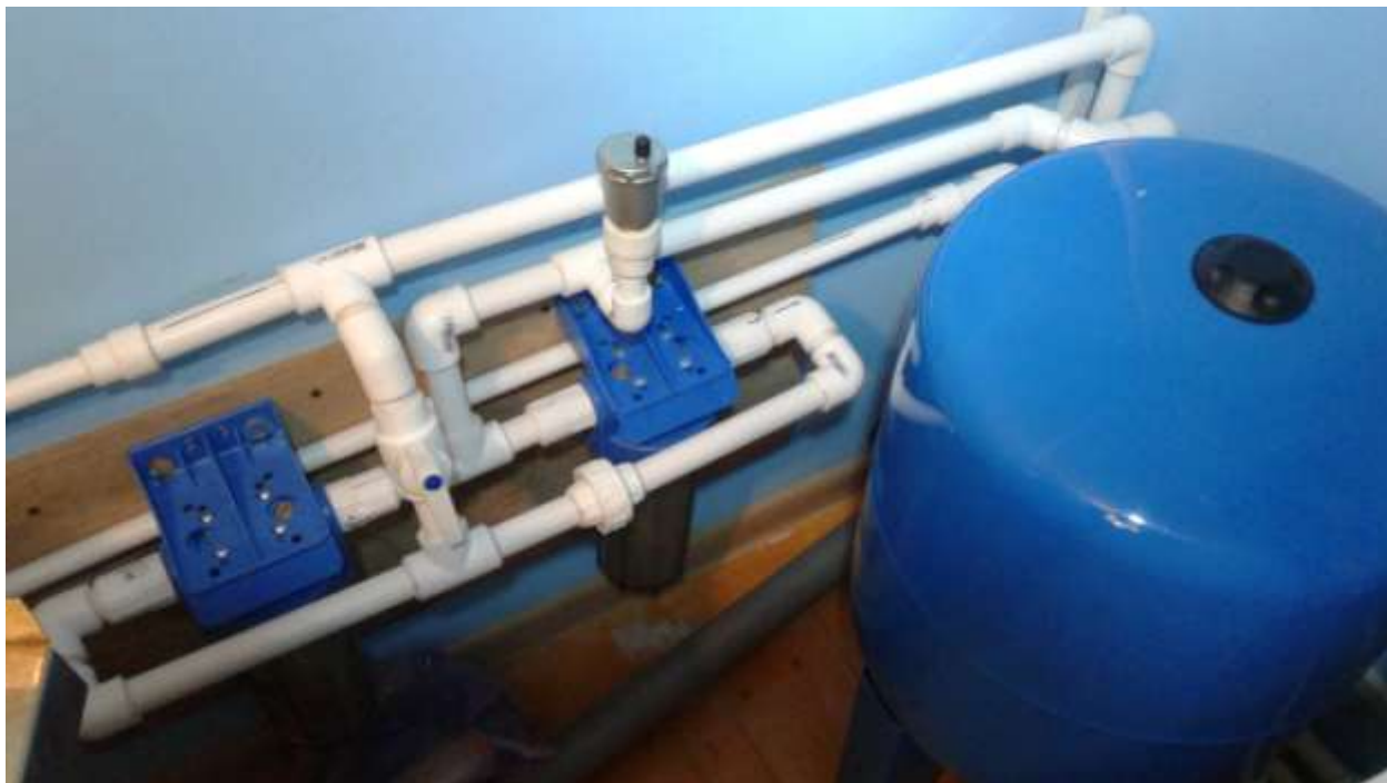
Рисунок 3 – Элементы системы водоснабжения в частном доме: (фильтры механической очистки и накопительный мембранный бак)
