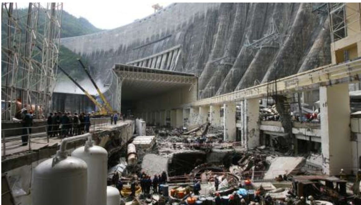
Рисунок 1 – Авария на Саяно-Шушенской ГЭС
