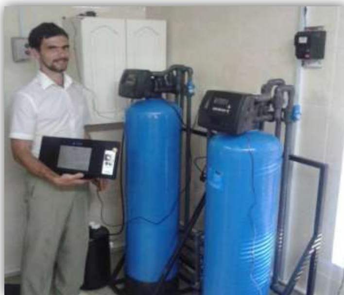
Рисунок 3 – Установка по очистке питьевой воды «Аквалелл 20К», установленная в гимназии №25 ст. Азовская Краснодарского края.
