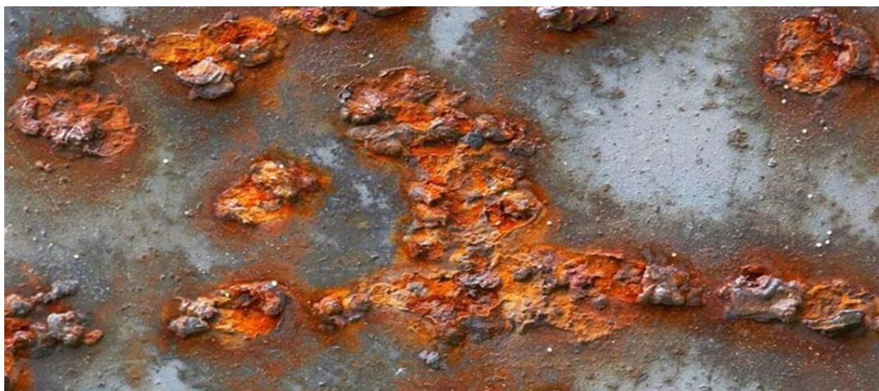
Рисунок 1 – Пример коррозии металла
